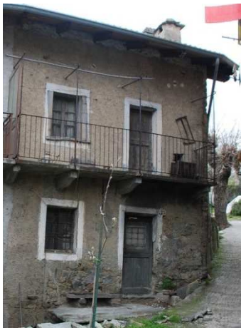
Balconi con aggetti in pietra e ringhiere metalliche a bacchetti verticali. Si notino i modiglioni sagomati a sostegno dello sporto, collocati in considerazione delle aperture ai vani ed in grado di "cadenzare" il prospetto
